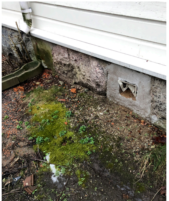
Kuva 41. Kuva lämmitysuunin ilmakeinavasta, sadevesi-syöksystä sekä betonikourusta. 15.12.2021.
