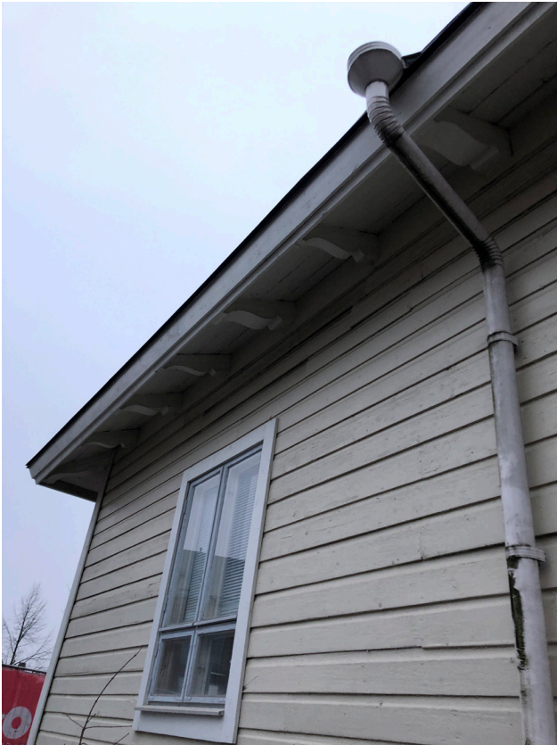
Kuva 42. Kuvassa kattokannattajat. Julkisivuverhouksessa on paikoin uusittuja paneeleita. 15.12.2021.
